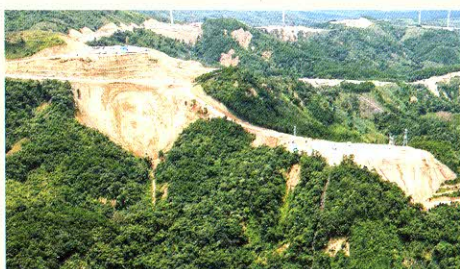
Một khu vực xây dựng dự án điện gió tại huyện Hướng Hóa (tỉnh Quảng Trị) có nguy cơ sạt lở lớn khi mùa mưa bão đến gần
