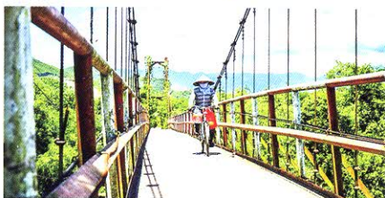
Cầu treo Thác Trâu (huyện Khánh Vĩnh) đang trong tình trạng cần duy tu, khắc phục trước mùa mưa bão 2021
