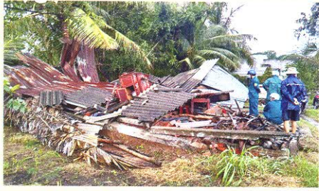
Một nhà dân ở huyện Mô Cày Bắc, tỉnh Bến Tre bị đổ sập do giông lốc ngày 25/7
