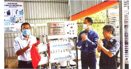
Khánh thành hệ thống lọc mặn công nghệ RO do GPI tài trợ.
