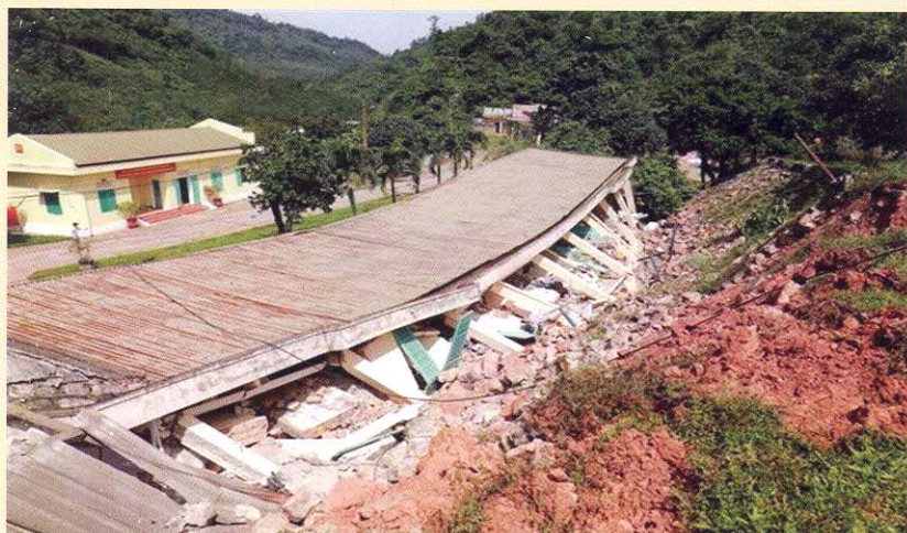
Sạt lở núi nghiêm trọng xảy ra rạng sáng 18/10/2020 ở thôn Cọp, xã Hương Phùng, huyện Hương Hóa, tỉnh Quảng Trị do mưa lớn
