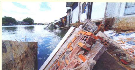
Hiện trường vụ sạt lở tại bờ sông Trà Nóc (quận Bình Thủy, Thành phố Cần Thơ)
