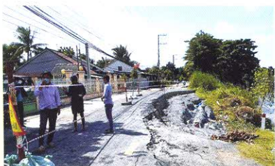
Đoạn tỉnh lộ 946 cập bờ sông Ông Chường bị sạt lở gần nửa mặt đường
