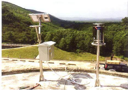
Lắp đặt một trạm đo mưa tự động Vrain trên địa bàn huyện Nam Đông, tỉnh Thừa Thiên Huế
