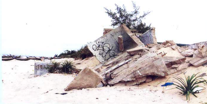
Công trình tại bờ biển xã Phú Thuận (huyện Phú Vang) đã bị sóng đánh hư hỏng
