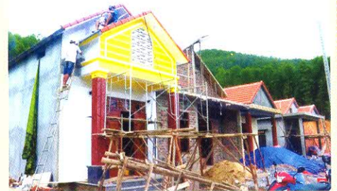
Người dân xã Thạch Hóa, huyện Tuyên Hóa (tỉnh Quảng Bình) hoàn thiện những công đoạn cuối của công trình nhà tái định cư
