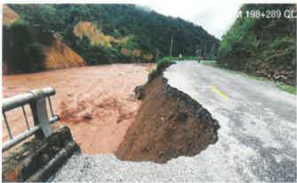
Sạt lở do mưa lớn từ 31/7 - 3/8 tại Km198+289 Quốc lộ 4H, địa phận Bản Tề Xá, xã Mù Cạ, huyện Mường Tè, tỉnh Lai Châu.
