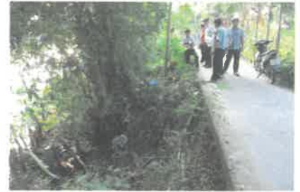
Nhiều điểm sạt lở đã lấn sâu vào đường giao thông.
