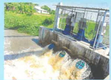
Hệ thống lọc nước tưới tiêu
