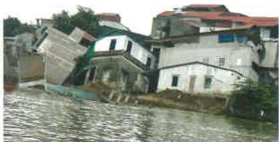
Hiện trường 6 ngôi nhà ở phường Vạn An, thành phố Bắc Ninh, tỉnh Bắc Ninh đã bị sụt lún xuống sông Cầu vào rạng sáng 7/4/2024
