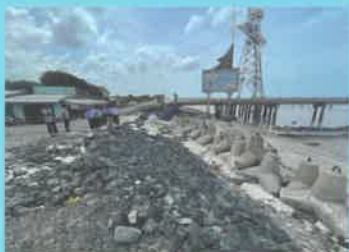
Hình ảnh sạt lở bờ biển Vĩnh Trạch Đông, tỉnh Bạc Liêu
